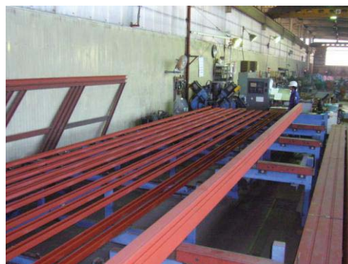
プレハブメーカー工場のユニットワーカー 軽量鉄骨の加工が短時間で大量に行われています
